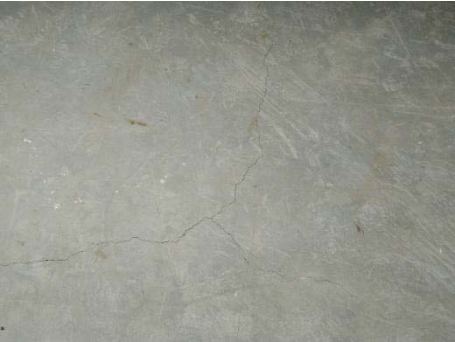
一、二、三层地面处存在多处裂缝（约 0.5mm）
