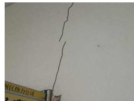
3~6 层内墙存在 1mm 竖向裂缝
