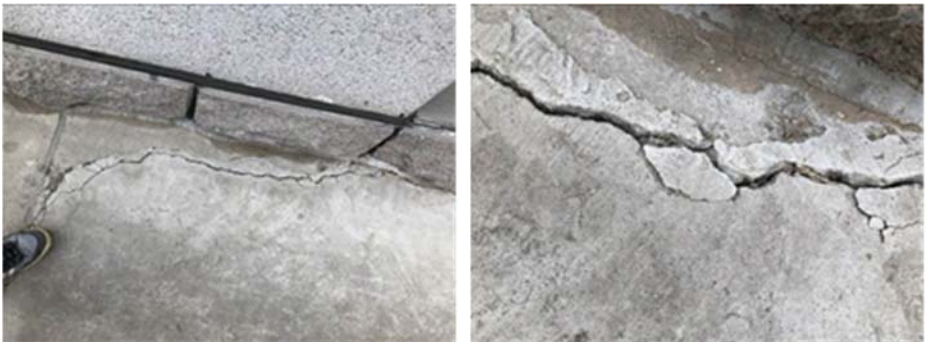
门诊楼南侧外墙沉降裂缝，宽约 3mm
