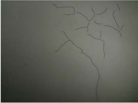
1 层配电室北侧墙体存在宽约 0.5mm 网状裂纹
