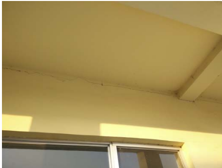
一层走廊位置梁侧存在通长的水平裂缝（约 1.5mm）
