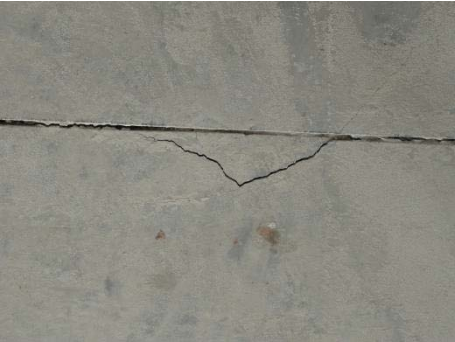
一、二、三层储备区西侧地面存在切割伸缩缝时形成的裂缝
