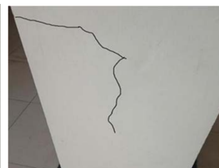
3、4 层部分柱存在宽约 1mm 的不规则裂缝
