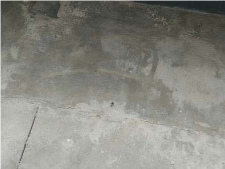
二、三层北侧贴近外墙位置处的地面存在后补混混凝土地板的现象（该位置处存在次梁）
