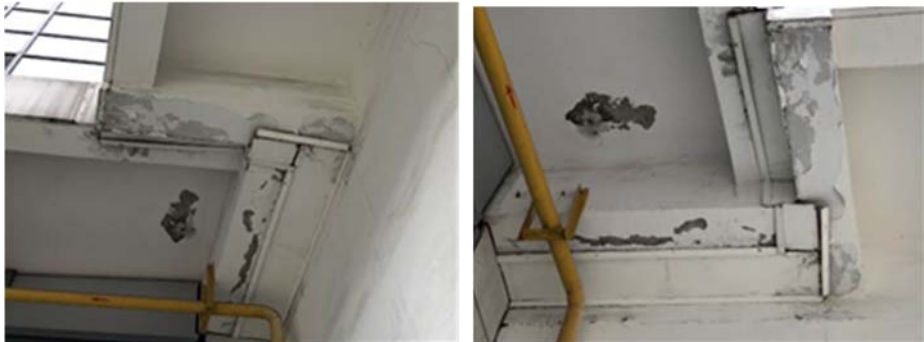
负一层餐厅南门外墙与管道连接处多处裂缝，宽度约 3mm
