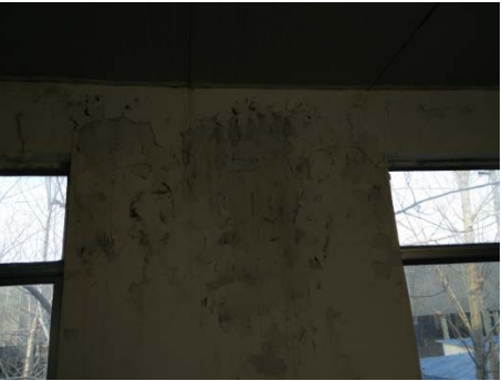
二层走廊中部某房间内墙破损严重，存在渗水现象
