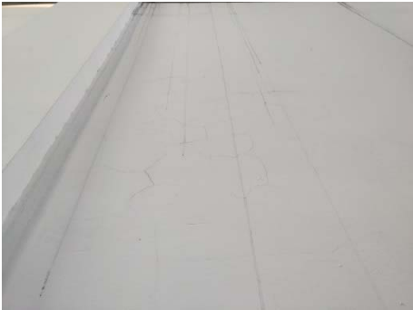
南墙外表面有网状裂缝
