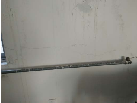
二层走廊中部某房间窗洞口位置内墙处存在水平裂缝
