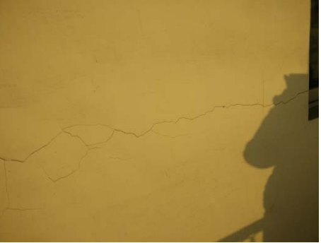
二层走廊西头位置内墙处存在通长的水平裂缝（约 2mm）
