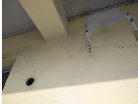
二层走廊位置内墙处存在水平裂缝（约 1.5mm）
