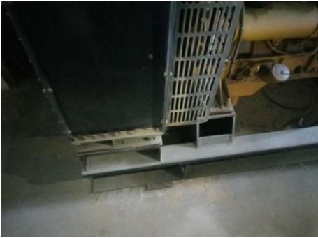
1 层配电室电机无锚固措施
