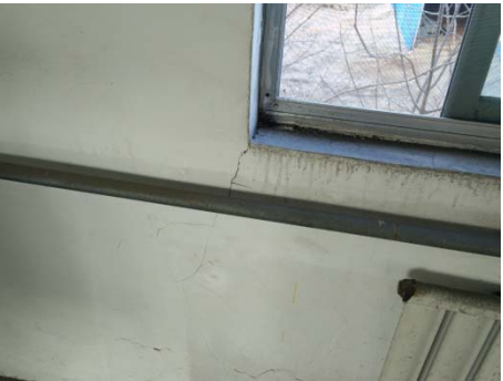
二层走廊东侧房间窗洞口位置内墙处存在斜向裂缝（约 1.5mm）
