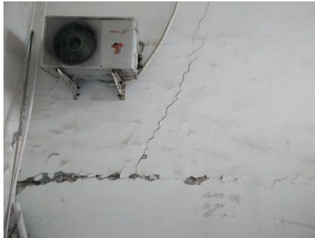
一层至二层楼梯间内墙处存在水平及斜向裂缝（约 4mm）
