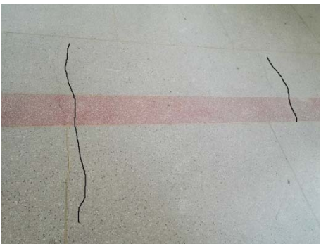
4 号楼东侧楼梯间处 1 层出现宽约 0.2mm 裂缝
