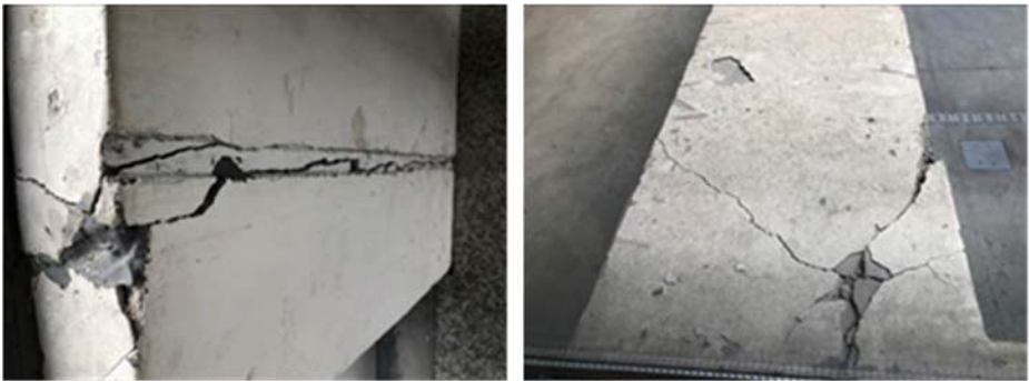
一层急诊楼至 2 号住院楼东侧走廊与楼房南侧连接处竖向贯穿裂缝，宽约 4mm
