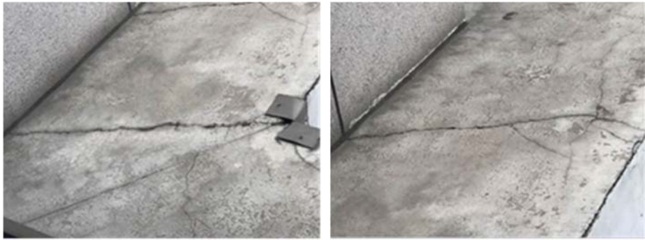
二层门诊楼至 2 号住院楼走廊悬挑板板顶斜裂缝，贯穿至板底，宽度约 1mm
