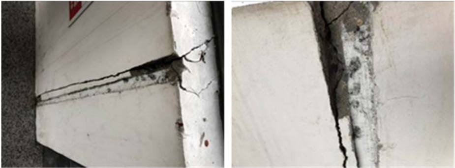
一层急诊楼至 2 号住院楼东侧走廊与楼房北侧连接处竖向贯穿裂缝，宽约 4mm
