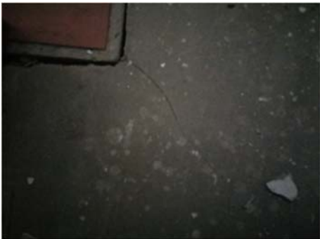
备用电机下侧存在宽约 2mm 斜裂缝
