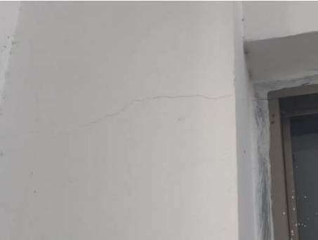
窗户连接处有横向裂缝宽度约 2~3mm
