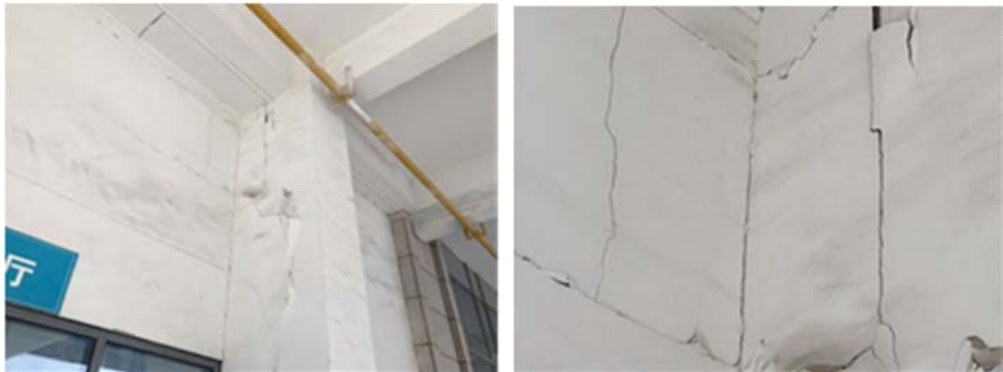
负一层餐厅东门外墙竖向裂缝，宽度约 2mm
