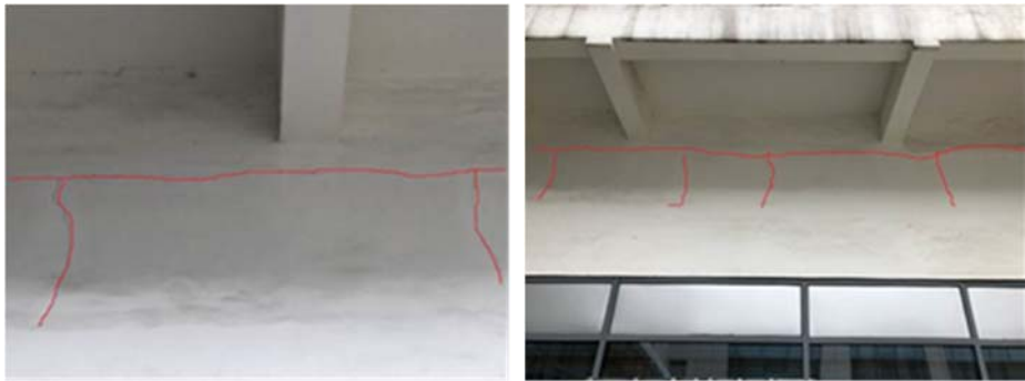
负一层营养餐厅北侧外墙多道竖向裂缝，宽度约 1mm
