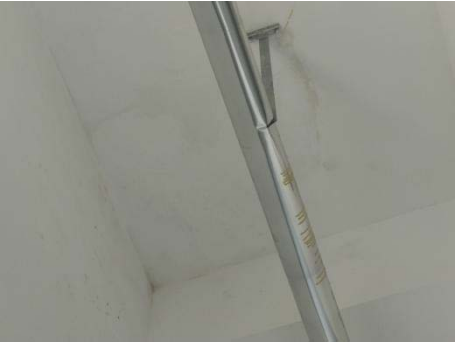
三层储备区局部顶板破损，存在漏水现象
