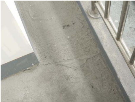
三层办公区北侧柱与地板连接处存在斜裂缝（约 1mm）
