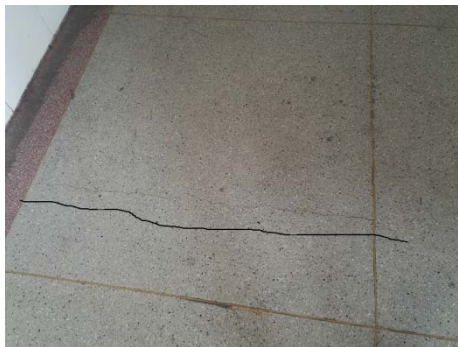
2 号楼东侧楼梯间处 1-4 层均出现宽约 0.4mm 裂缝
