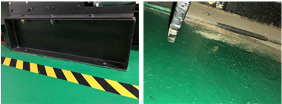
备用发电机未锚固直接放置于地面上，未设置螺栓连接未焊接
