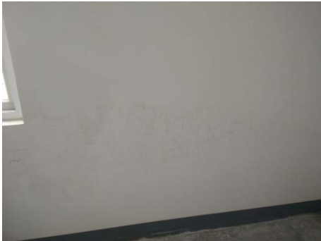
三层储备区北侧内墙破损并存在渗水现象
