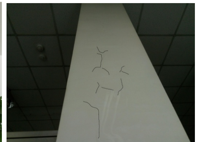
图 4.7-2 柱体裂缝情况
