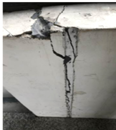
图 4.5-1 走廊连接处裂缝情况
