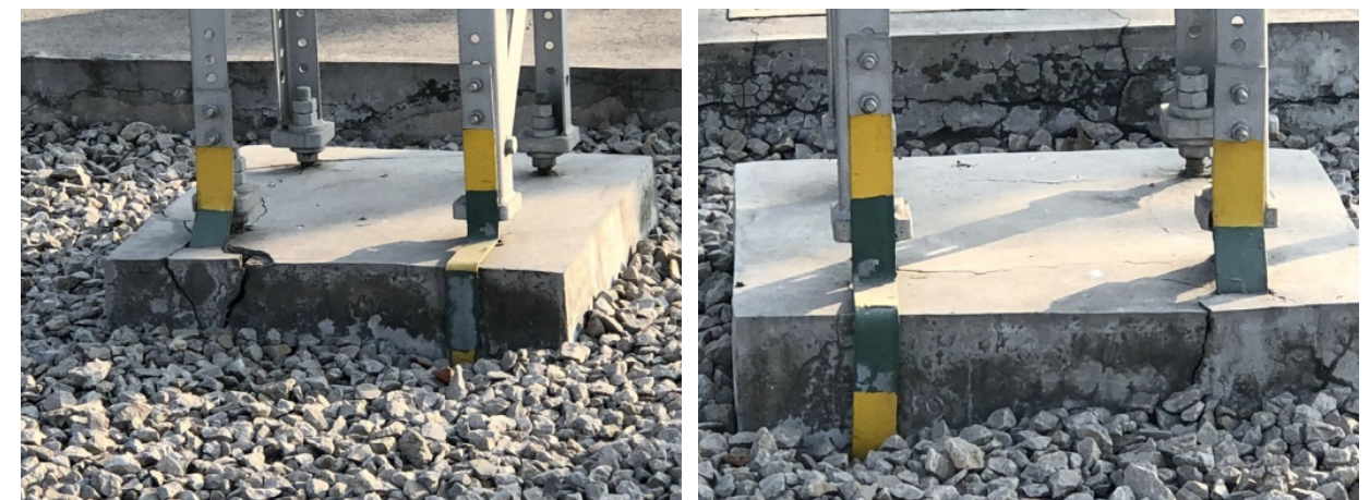
图 4.1-7 支座严重开裂
