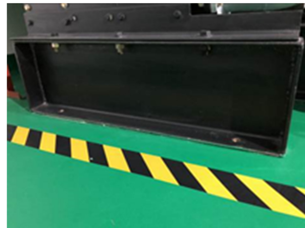
图 4.5-3 备用发电机组无锚固措施
