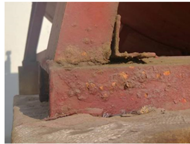
图 4.1-9 焊点出现裂缝、角钢脱离
