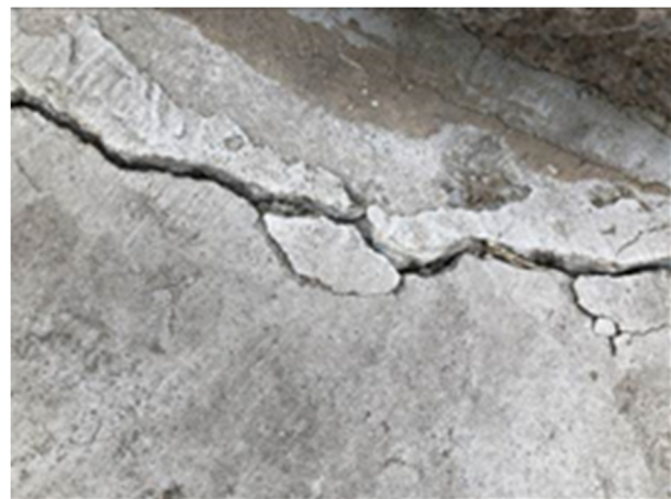
图 4.5-2 沉降裂缝情况
