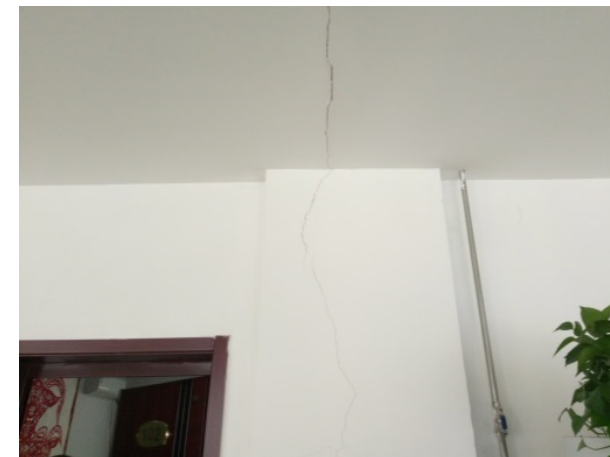
图 4.7-1 墙体裂缝情况
