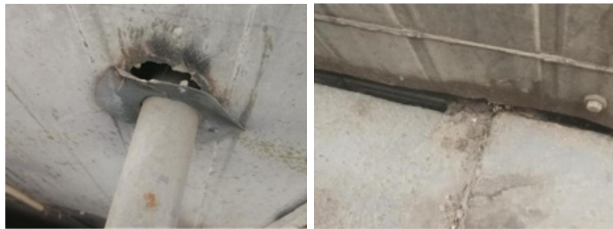
图 4.9-1 建筑外楼梯扶手与建筑物连接及锈蚀情况
