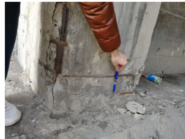
图 4.2-1 桥墩底部钢筋外露
