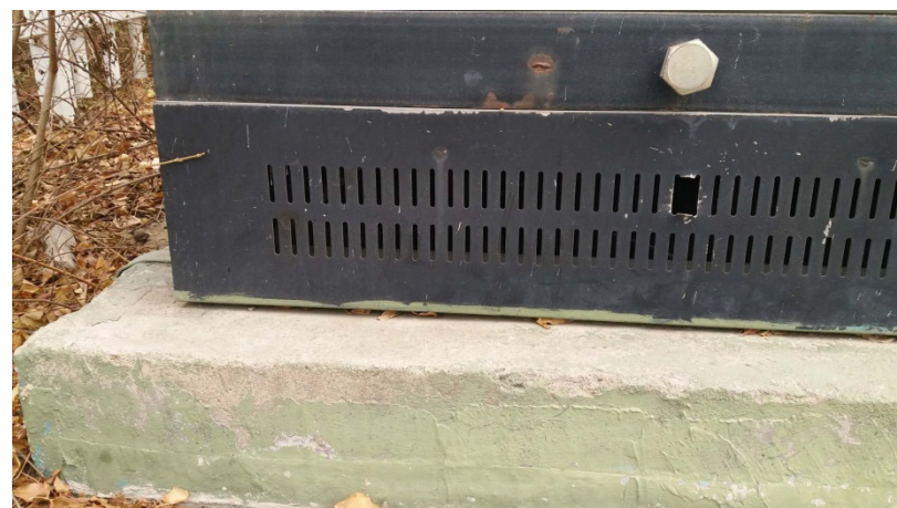
图 4.1-10 变电站设备与基础无螺栓锚固或焊接不牢固
