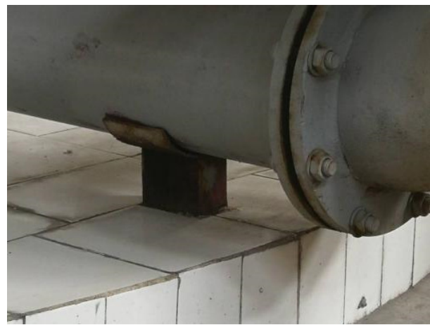
图 4.1-8 过滤器管道直接摆放在支座无固定措施
