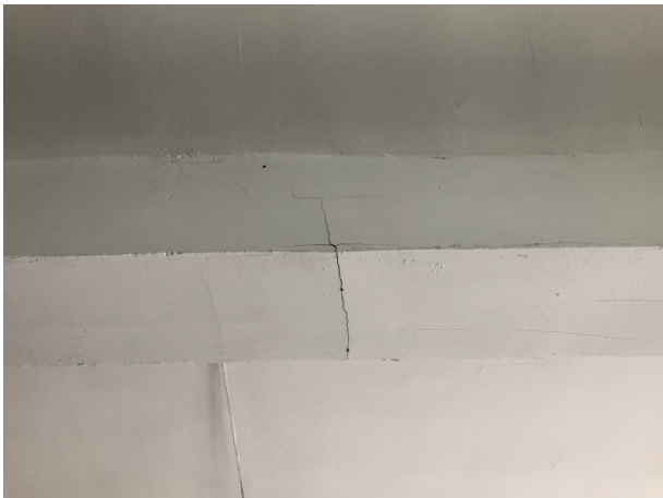
图 4.3-2 顶板梁破损情况
