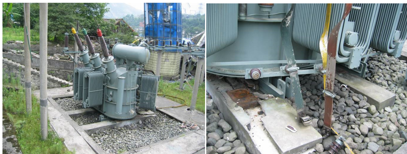
图 4.1-1 汶川地震中变电站水平移位的主变压器
