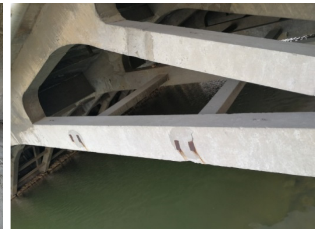
图 4.2-2 桥底斜杆节点处生锈
