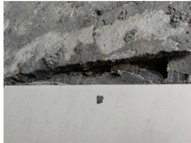
图 4.1-5 平台与墙柱连接处存在缝隙
