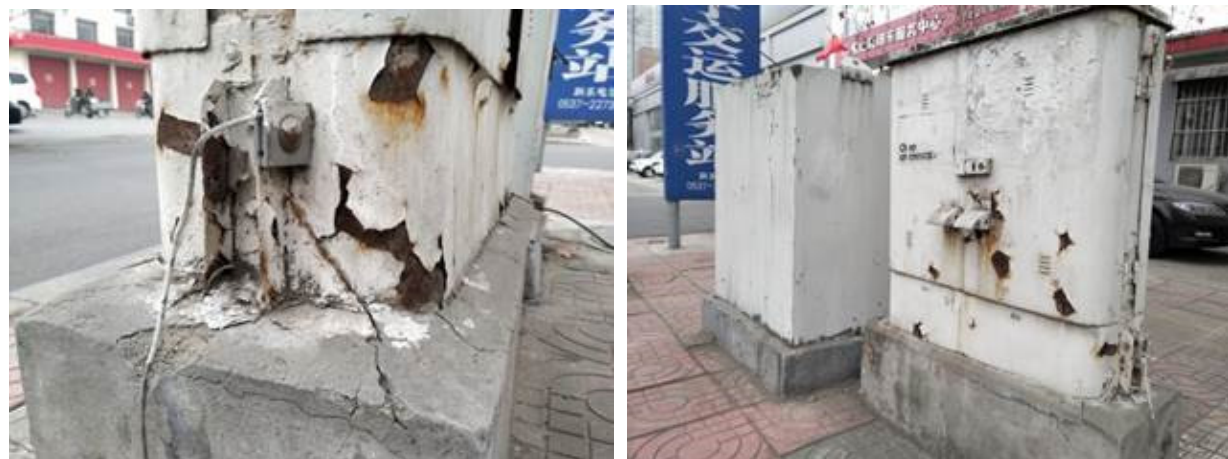
图 4.7-6 任城区济安桥北路 66 号通信箱现状
